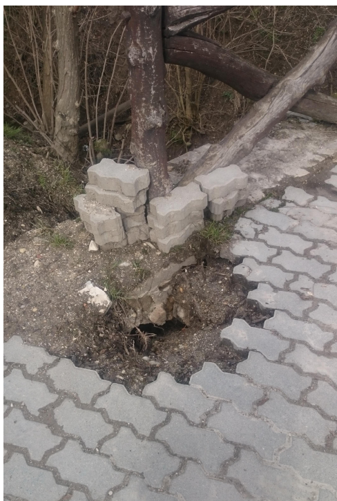
3. Kép - Budai út 30. és Híd utca találkozása. (Híd lábainál a térburkolat kimosódása.)
