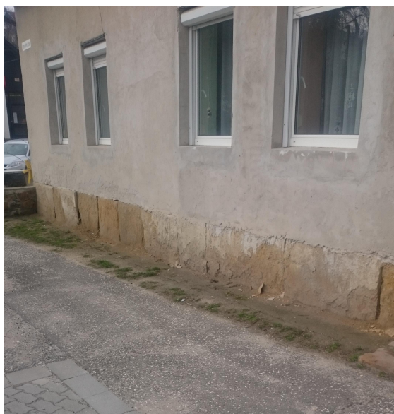
7. Kép - Felázás a Budai út 30. és a Híd utca találkozásánál
