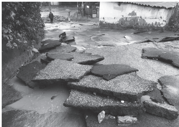
A Tücsök utca megsemmisült útburkolata közvetlenül az özönvíz után
